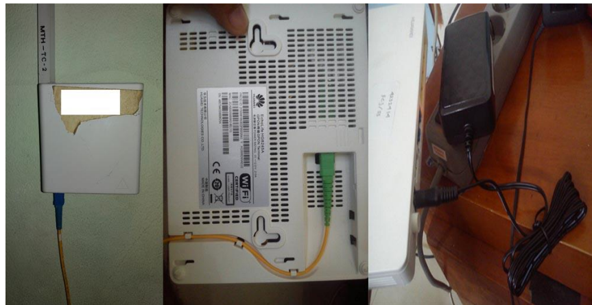
Gambar 3.15 Instalasi ONT pada Roset
