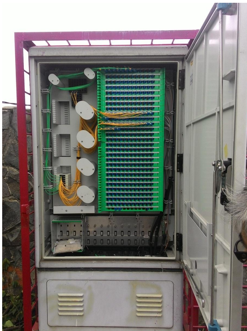
Gambar 9 Optical Distribution Cabinet (ODC)
