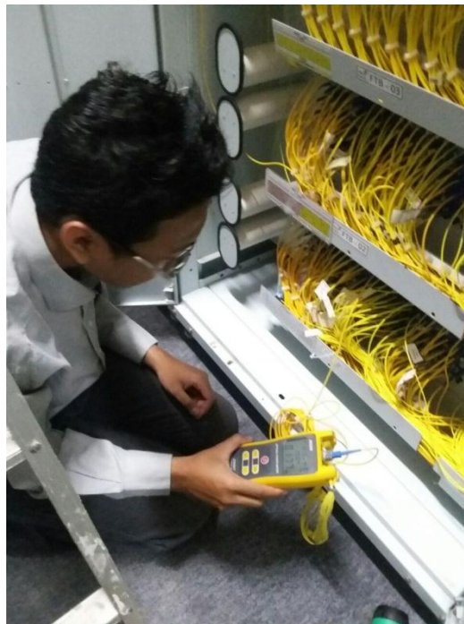
Gambar 13 Pengecekan redaman di FTM E-akses
