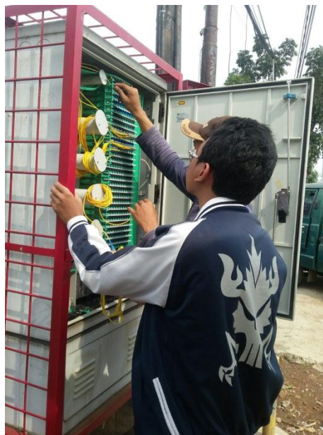
Gambar 16 Proses pengukuran level redaman pada panel ODC
